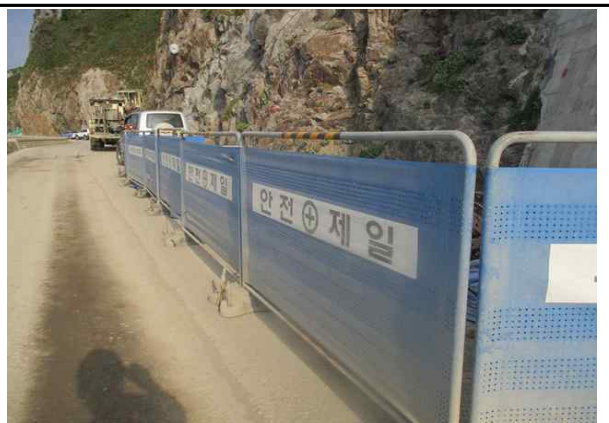
도로 안전 펜스 현황
